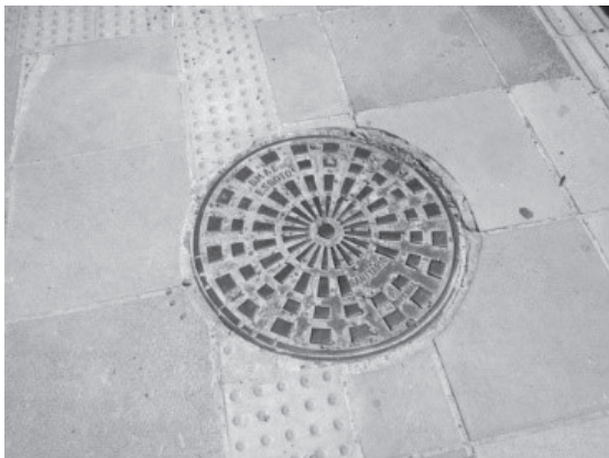
Figura 5. Tampa de bueiro sobre o piso tátil, na Avenida Paulo Gama.
