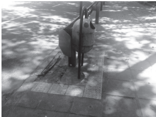
Figura 2. Piso tátil sinalizando a lixeira pública, mas não a defesa metálica, na Rua Engenheiro Luiz Englert.
