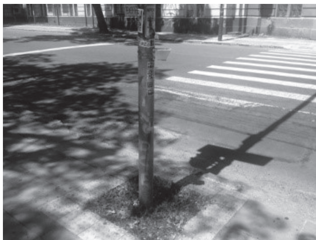
Figura 3. Sinalização de trânsito em frente à faixa de segurança e com botão em altura inadequada a pessoas com deficiência visual e física, na Avenida Paulo Gama.
