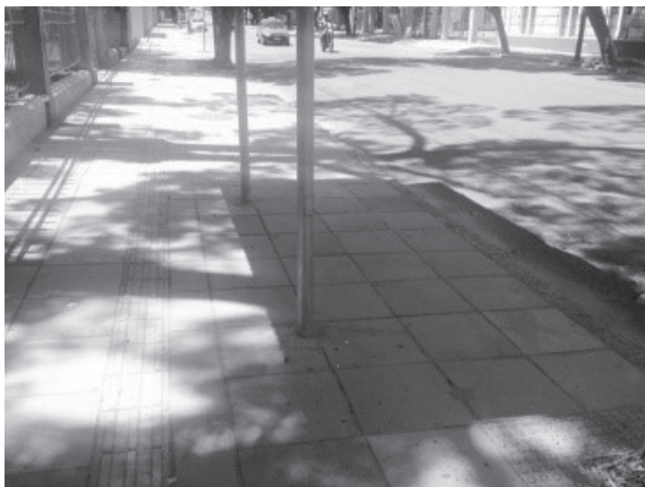
Figura 4. Ausência de sinalização sobre a parada de ônibus, na Rua Paulo Gama.
