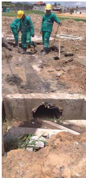
Figura 3 – Tubulação para drenagem no entorno do trecho 1 do Parque Lagoa da Viúva Fonte: Bons Jardins Urbanos, 2021.
